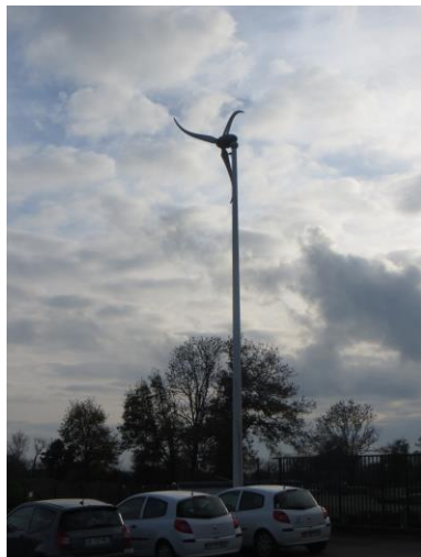
Illustration 14: Petite éolienne installée sur le parking d'une entreprise de l'@lphaparc
