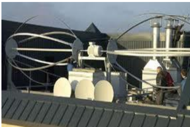
Éolienne de type Darrieus
